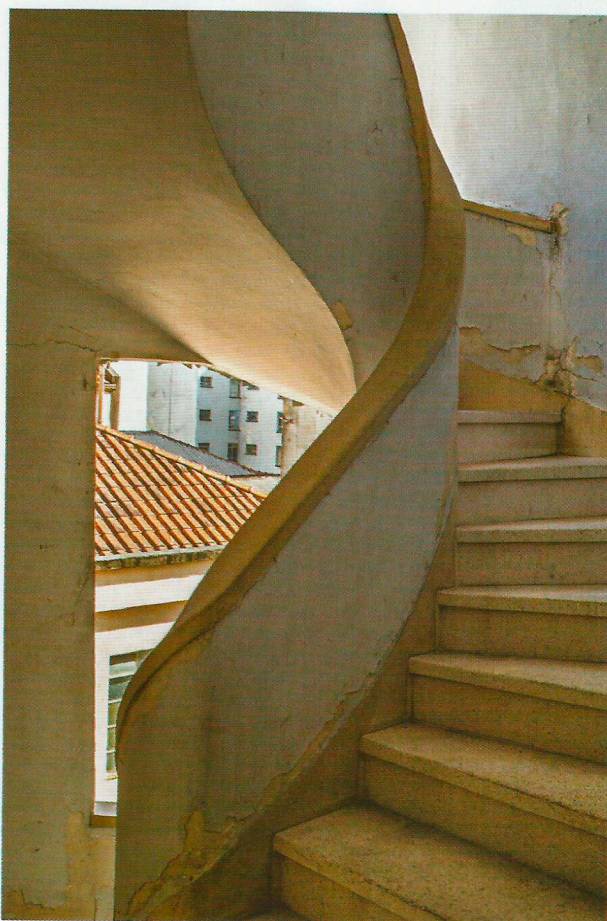
Enquanto a forma das escadas evoca a poesia do traço modernista, o descascado da pintura confirma o descaso com a obra.
