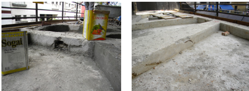
Figuras 18 e 19 - Fotos das armaduras expostas na marquise inferior
