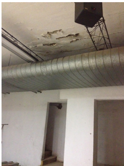
Figura 42 - Ferragens expostas na laje do subsolo, abaixo dos sanitários do térreo
