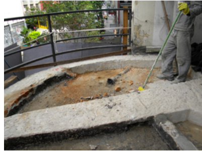
Figura 15 - Tubos de captação de água
