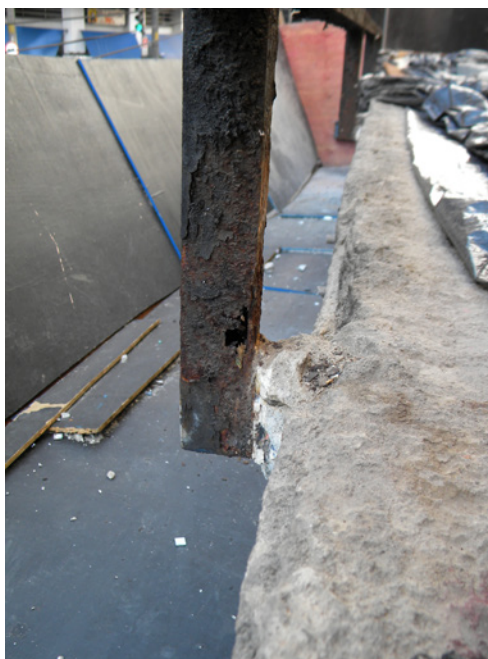
Figura 33 - Guarda corpo - Situação atual
