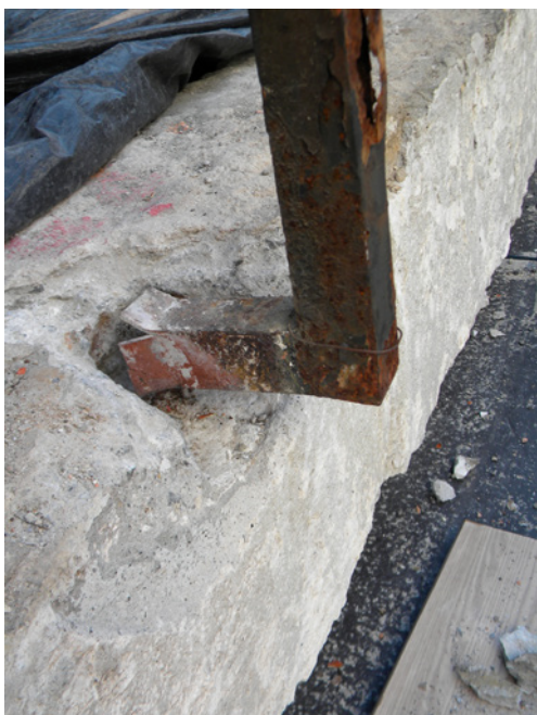
Figura 32 - Guarda corpo - Situação atual
