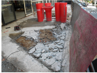
Figura 14 - Caixaão perdido preenchido de entulho
