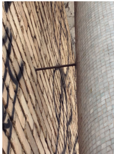
Figura 54 - Tirante - área externa
