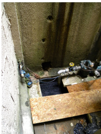
Figura 39 - Reservatório externo de esgoto no subsolo
