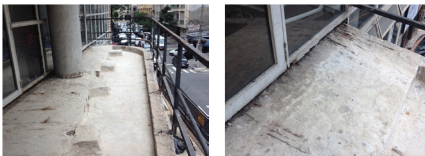
Figuras 21 e 22 - Ralos e armaduras expostas na marquise superior
